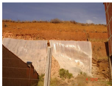
Figura 3-12 - Risco de escorregamento na margem da ES-080, bairro Cinco Casinhas.
