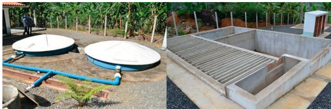
Figura 30 – Reservatórios ETA Sagrada Família (Reservatórios 20 m 3 )
