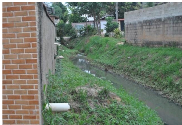
Figura 58 – Situação localizada - descartes do sistema de microdrenagem
